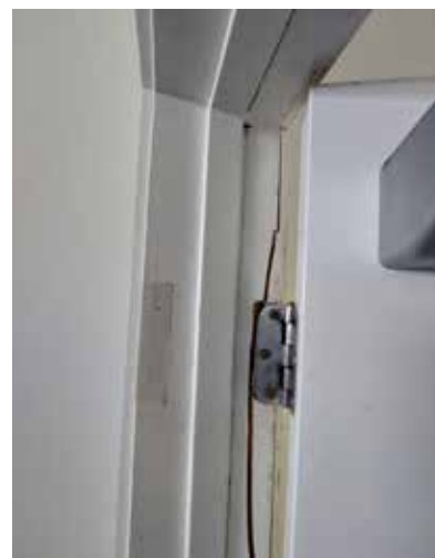
Damaged door jamb.
