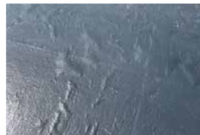
Bubbling under liquid-applied membrane.
